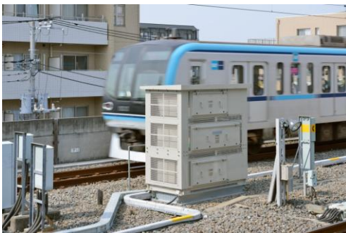
駅補助電源装置
