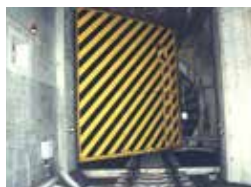
坑口浸水対策（防水ゲート）
