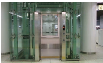
エレベーター
