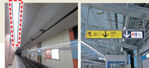
LEDを用いた駅構内照明
