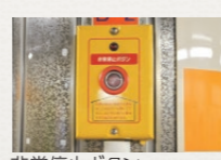
非常停止ボタン
