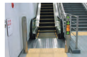
自動運転装置付エスカレーター
