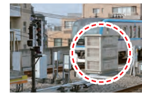
駅補助電源装置
