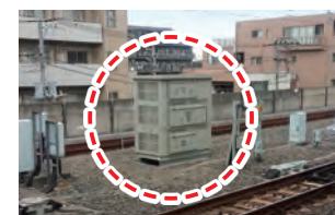
駅補助電源装置
