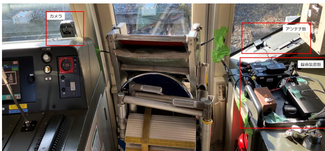
▲機器設置場所（仮設時の写真）
