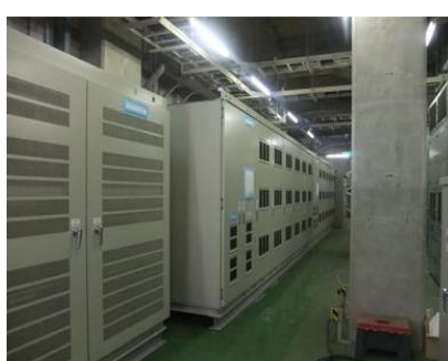
【非常用地上バッテリー装置外観】
