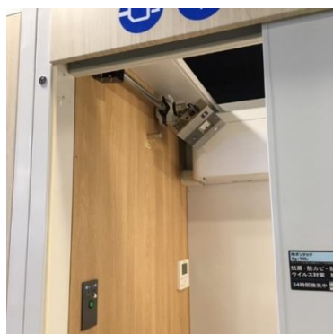
ブース内設置状況
