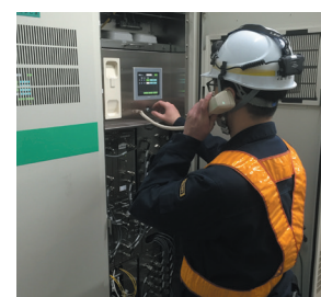
通信設備検査
