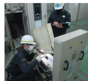
変電設備検査
