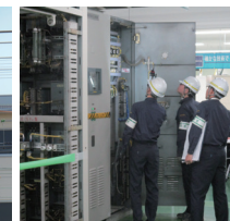
電気部変電分科 技能競技会
