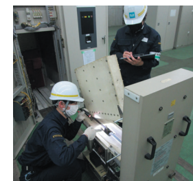
変電設備検査
