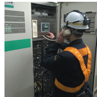
通信設備検査
