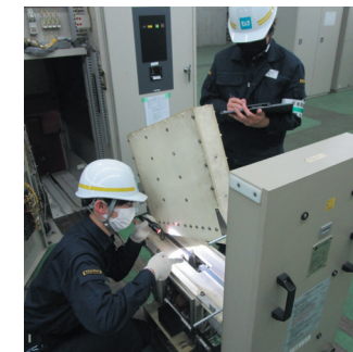
変電設備検査
