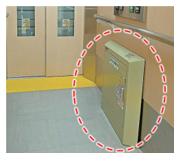
エレベーター内非常用品
