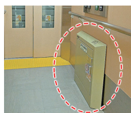
エレベーター内非常用品
