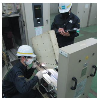
変電設備検査
