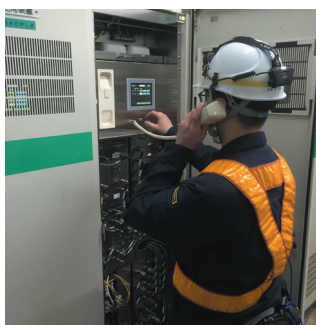
通信設備検査
