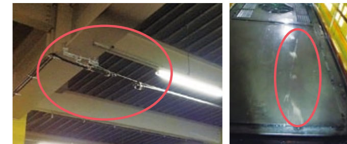
銀座線渋谷車両基地側線ケーブル垂下部
